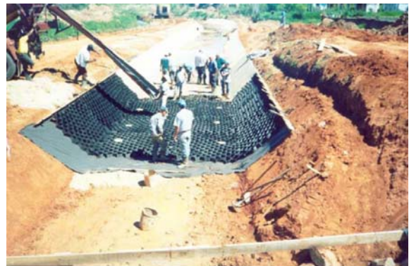
Figura 4 – Drenos no fundo do canal para alívio de sub-pressões.
